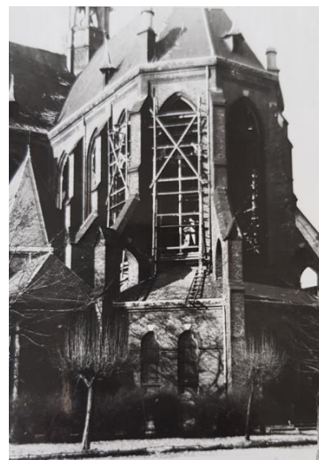
Die zerstörten Chorfenster
